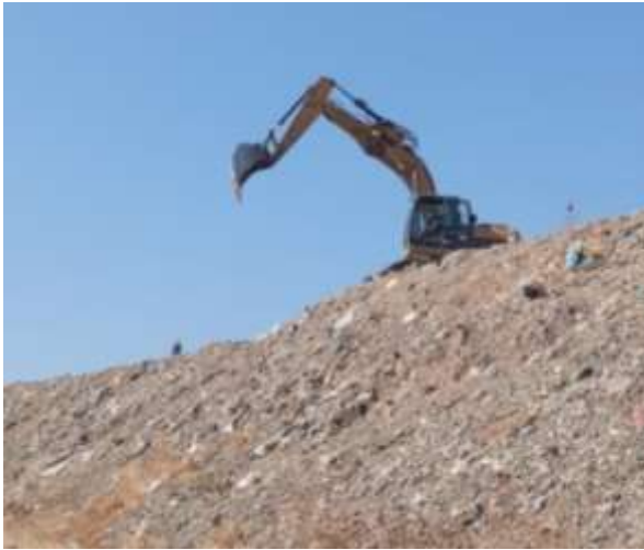
Reubicación de residuos sólidos para la conformación de las banquetas intermedias de las macro celdas 1 y 2.
